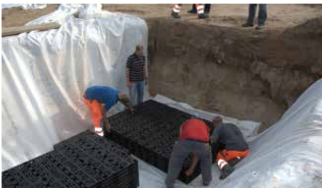
Para la infiltración de las aguas pluviales depuradas, se montaron elementos de infiltración DRAINFIX BLOC.
