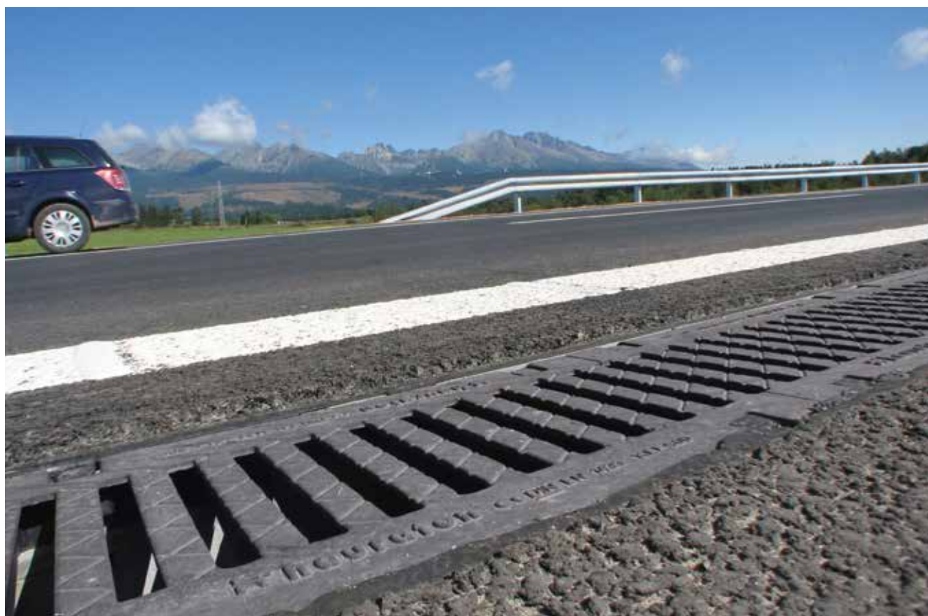
Drenaje de carreteras, Eslovaquia
